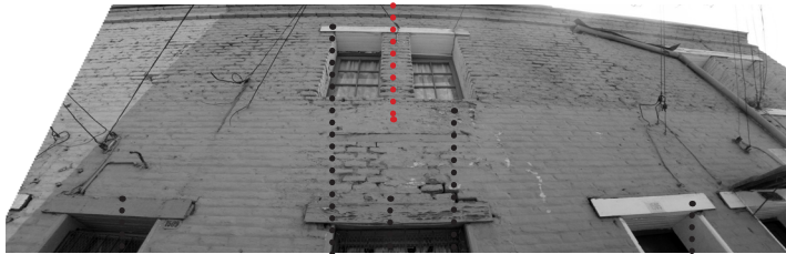
ELEMENTOS DE MADERA NO ORIGINALES
