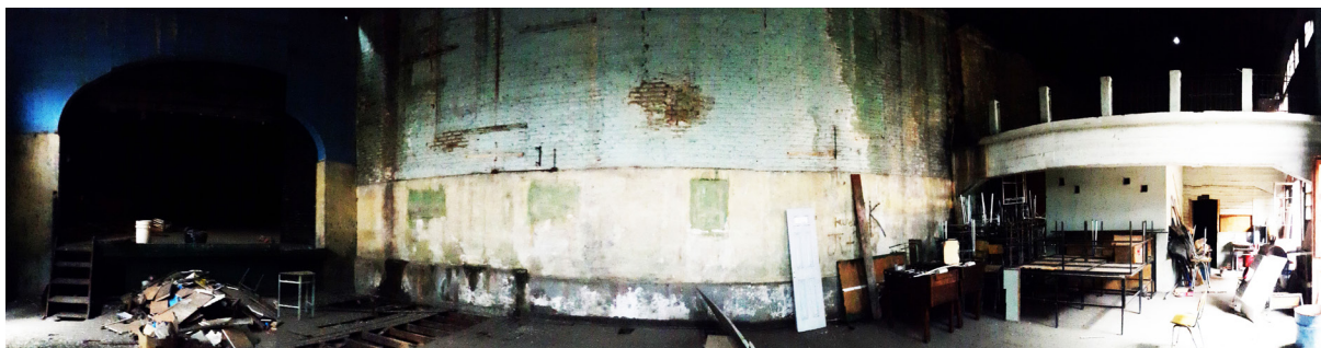
Vista panorámica de muro medianero con teatro. En el centro la grieta de corte que coincide con el medianero perpendicular que cierra las viviendas en estudio
