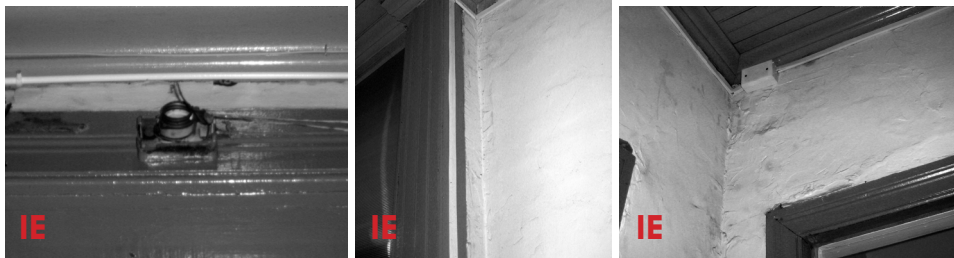
Imagen 103: Conjunto, espacialidad, daños y modificaciones en la unidad de vivienda 08.
